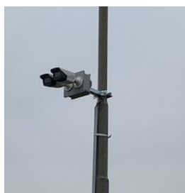
Telecamere di sicurezza
